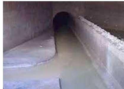
Un exemple de déversoir d'orage Source : Guide technique sur le fonctionnement des déversoirs d'orage - ENGEES - FNDAE, 2006
